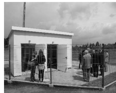
Nowoczesne instalacje spełniają wymogi XXI wieku
