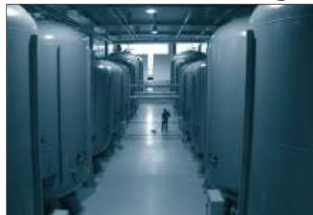
Nowa stacja uzdatniania wody dla miasta - Wierzchowisko
